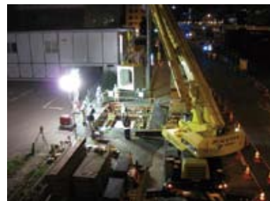
都心部や景観保護地区を中心に配電線地中化が計画的に進められている（北海道電力）
